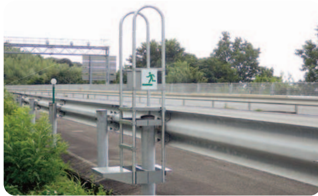
ガードレール
